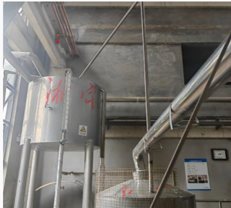
醬酒車間冷卻水回用澡堂用水安裝完成
