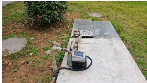
趙家溝廠區中水回用項目
