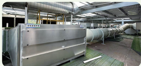
廢氣處理設備
