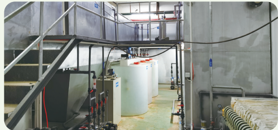
自建污水處理設施
