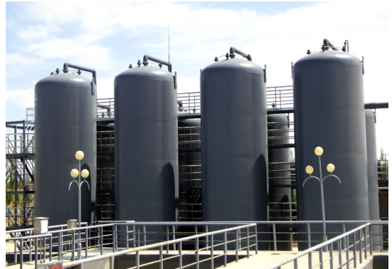
廢氣處理設施
