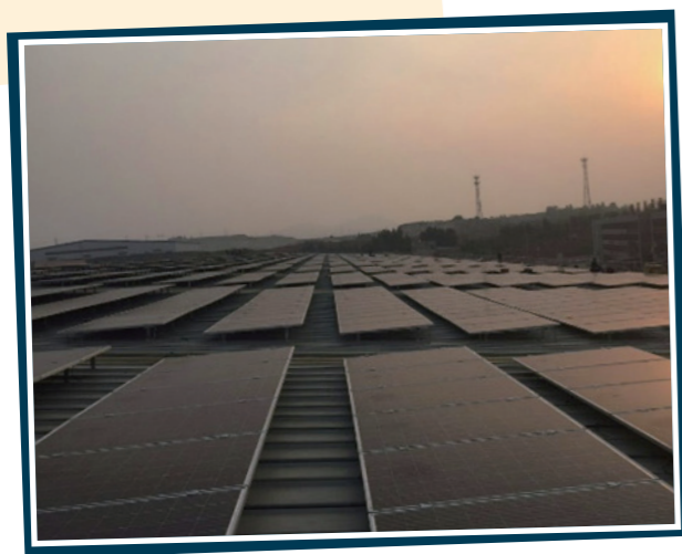
蒙城屋頂分佈式 光伏電站
