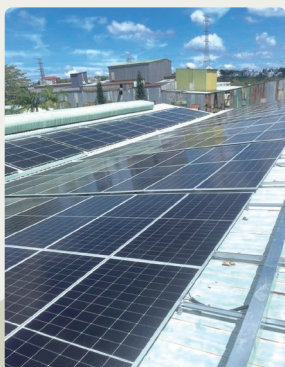
創匯添廠房二期的 太陽能發電系統
