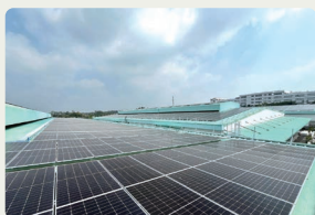
創匯添廠房一期的 太陽能發電系統
