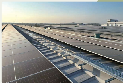
裕欣廠房一期的 太陽能發電系統
