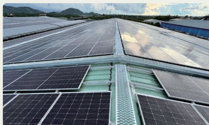
裕欣廠房二期的 太陽能發電系統
