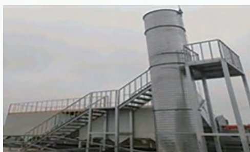
注塑廢氣處理系統
