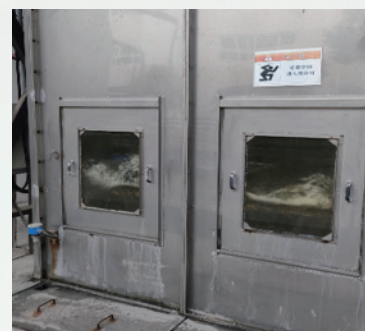
污水處理站低溫蒸發設備
