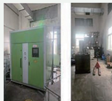
油水分離設施
