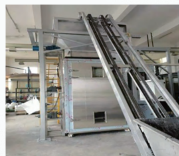
污泥乾化設備
