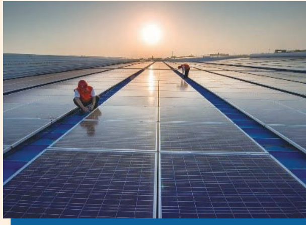
蘭考恒大家居產業園太陽能光伏
