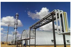
井口气回收装置
