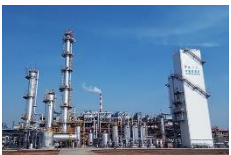
天然气、煤层气、焦炉气液化装置
