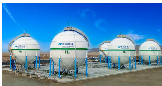
华电绿氢示范项目 6 台 1,500m 3 氢气球罐
