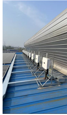
光伏项目实施改善前
