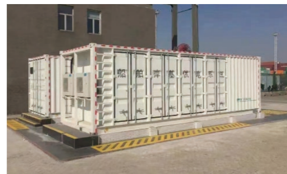
船舶岸基供電系統
