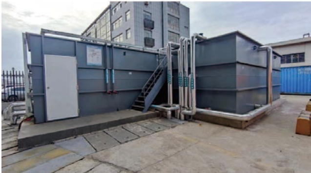
連雲港新東方碼頭利用污水處理站處理和淨化污水，實現達標排放或回用。
