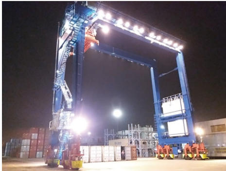
錦州新時代碼頭的「場橋幕牆式照明系統」項目。
