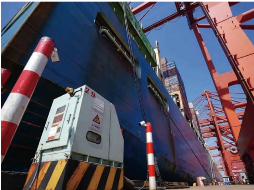
天津集裝箱碼頭的綜合節能型場橋供電系統。
