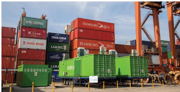
於和記港口鹽田國際的岸電系統
