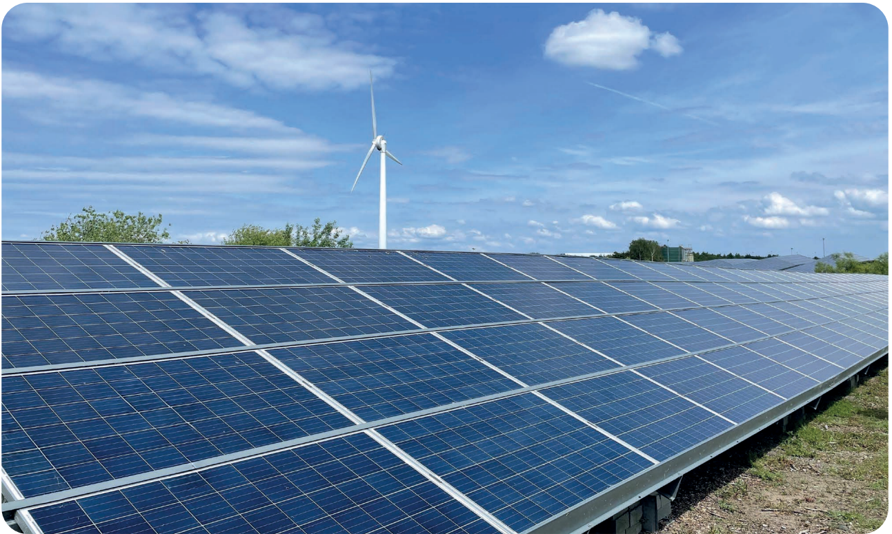
Powerlink Renewable Assets 安裝的實地太陽能板
