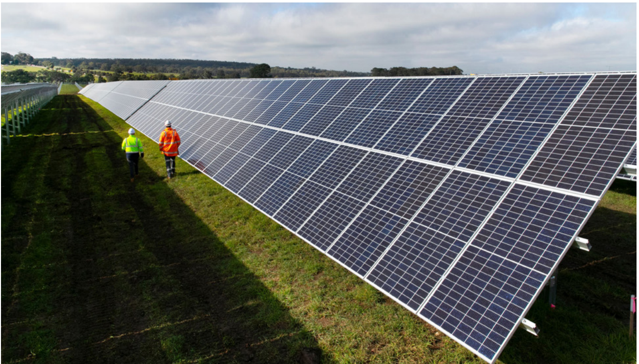
Beon Energy Solutions 在墨爾本機場開發的太陽能光電陣列
