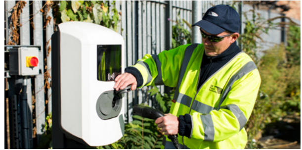
UK Power Networks 安裝的 EV 充電器
