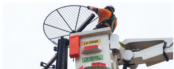
SA Power Networks 安裝保護裝置以保護野生動物
