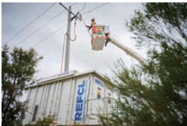
Powercor 安裝快速故障電流限制器
