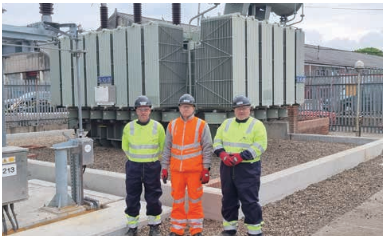
UK Power Networks 完成一項為數 500,000 英鎊的防洪計劃，為 69,000 戶家庭和企業提升電力供應的恢復能力。
