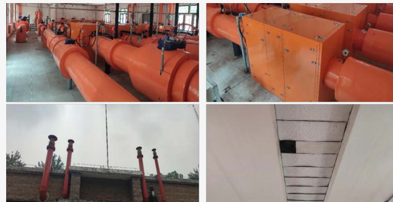
降噪改造后的高压站
