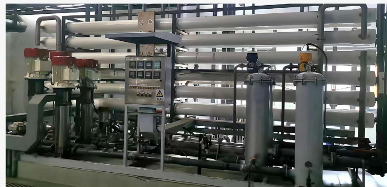
渗滤液处理设施
